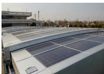
小雀浄水場ろ過池 太陽光発電設備
