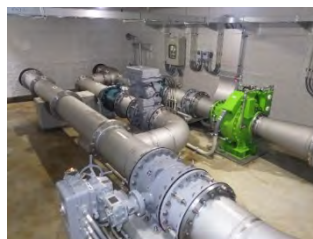
恩田配水池 小水力発電設備
