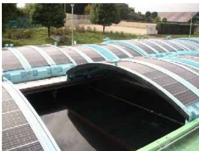
「小雀浄水場ろ過池・ ふくが 覆蓋型太陽光発電設備」
