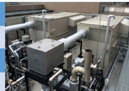
コージェネレーションシステム
