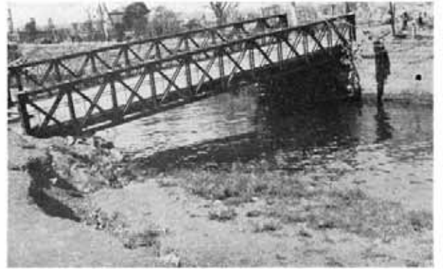
横浜市 谷戸橋被害直後の状況を南岸下流より望む
