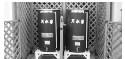
【「わくわく倶楽部」で設置した雨水タンク】
