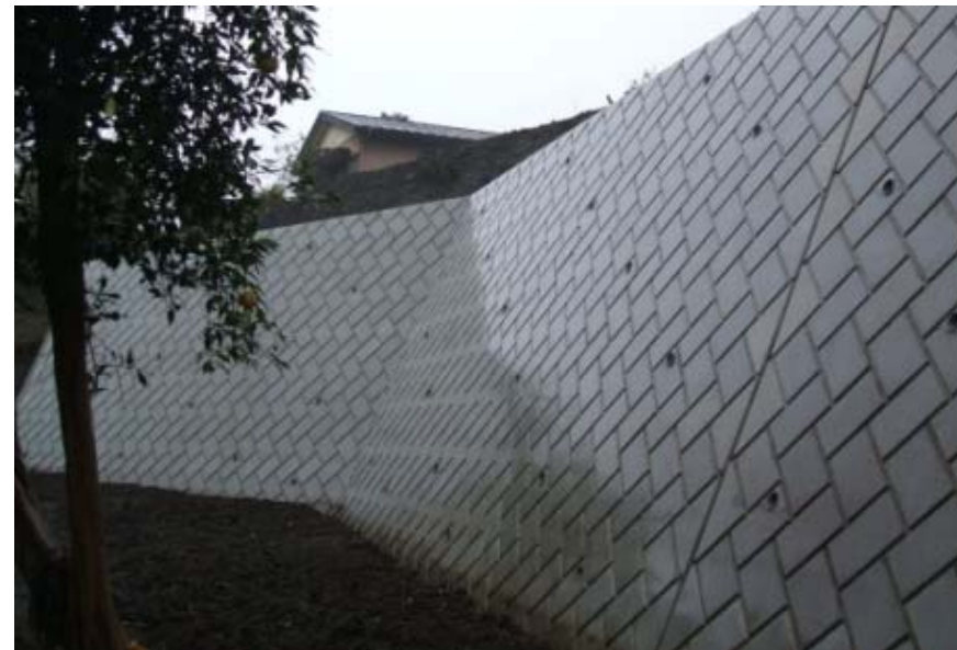
危険な崖の改善例
