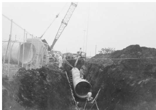
寒川取水施設から小雀浄水場を結ぶ2,000mm導水管布設工事
