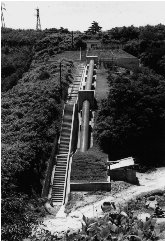
港南隧道配水池 流入口
