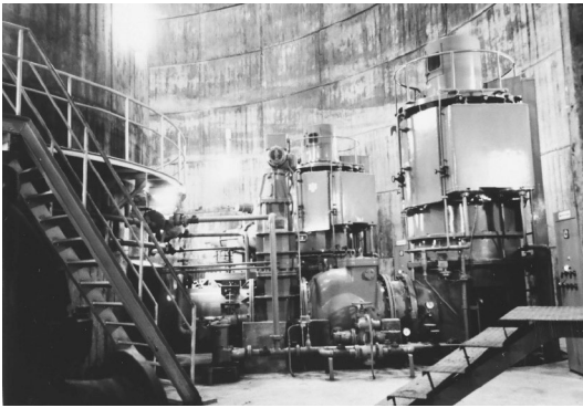
小雀揚水ポンプ場
