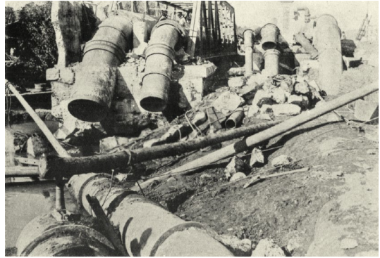
宮川水管橋 この水管破損により全市域が断水した（土木学会「関東大地震震害調査報告 第2巻」より）
