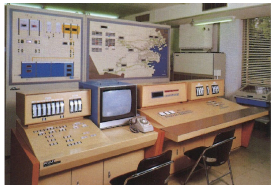
工業用水道管理事務所内の管理センター
