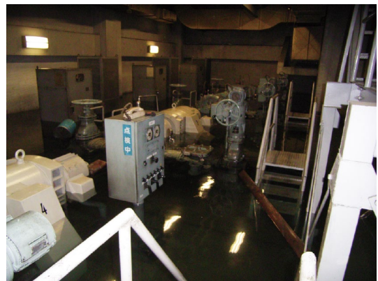
笹下ポンプ場地下の冠水状況
