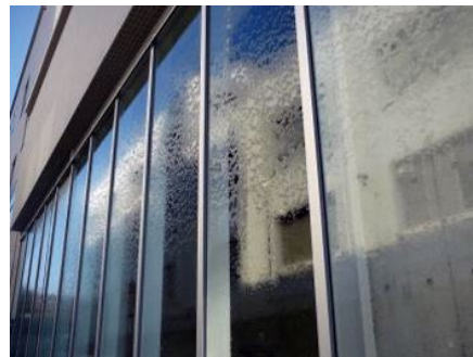
光触媒カーテンウォール散水システム
