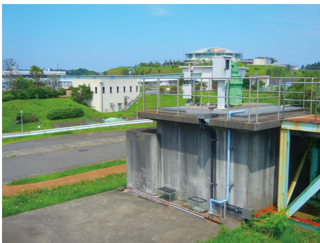
小雀浄水場 汚泥濃度調整槽
