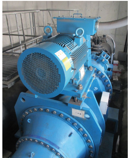
川井浄水場の小水力発電設備
