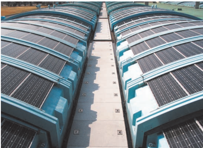
ろ過池の上部に設置された可動式太陽光発電設備 (小雀浄水場)
