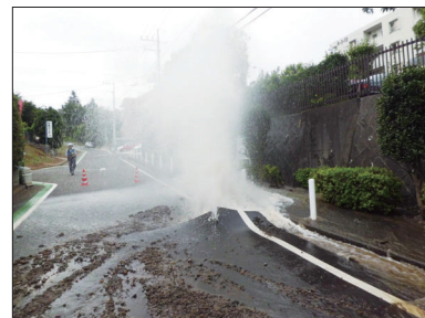
腐食による漏水
