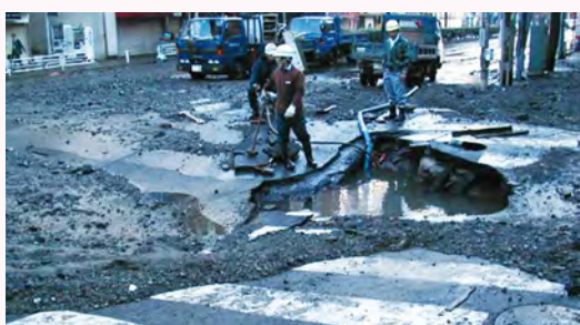
▲横浜市神奈川区鶴屋町での漏水
