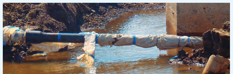
▲東日本大震災の津波にも耐えた耐震管 (平成23年 仙台市水道局提供)
