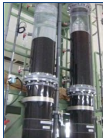
図 5.1.1 川井プラント
