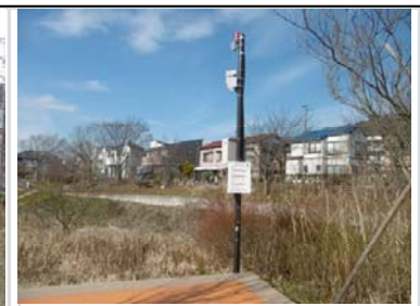
④大雨洪水警報装置
