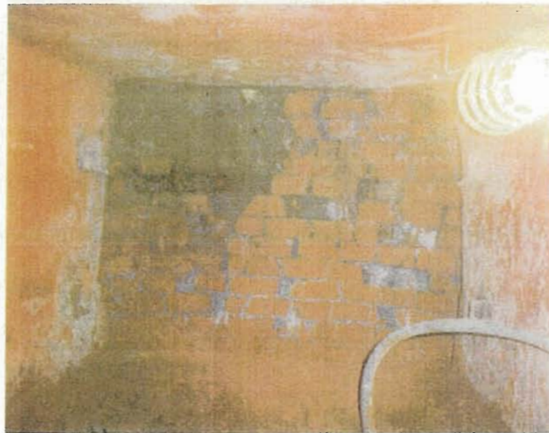
支障物 (レンガ積)
