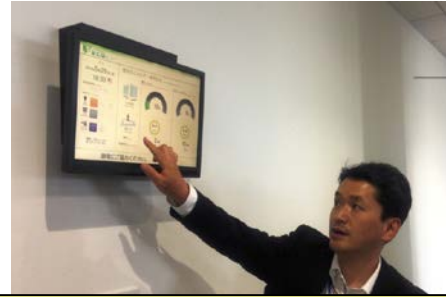
MM21 地区の業務ビルでは、各テナントに電力の使用状況を表示するモニターを設置
