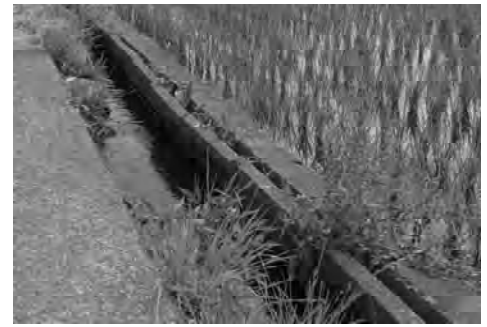
老朽化した用水路
