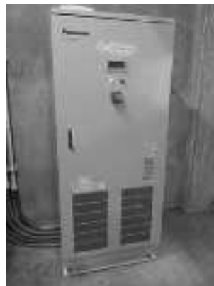
蓄電池の設置
