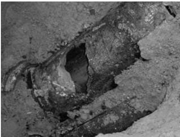
破損した取付管(パイプ)
