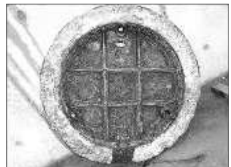
腐食したマンホール蓋
