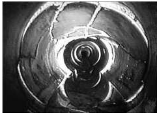
老朽化した下水道管(TVカメラで撮影)
