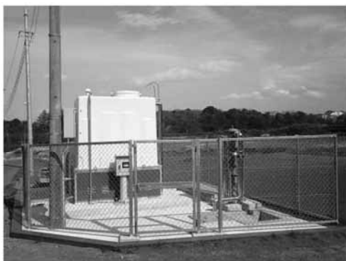
【写真】井戸及び配管整備 （都筑区東方町、向原地区畑地かんがい組合）
