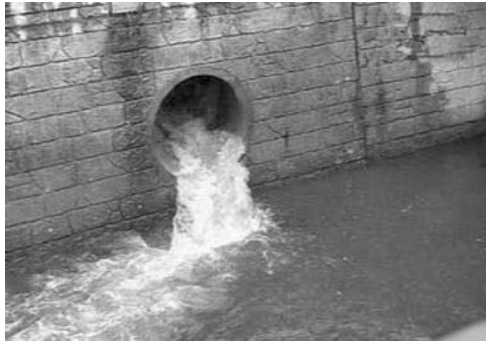
大雨時に河川等へ直接放流される下水の様子
