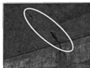
コンクリートのひび割れ、はく落 (今井町隧道：保土ヶ谷区)
