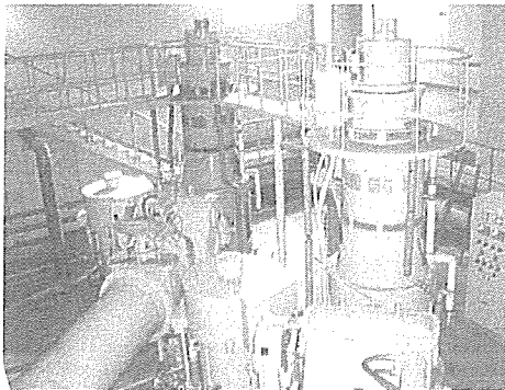
ポンプ場内部
