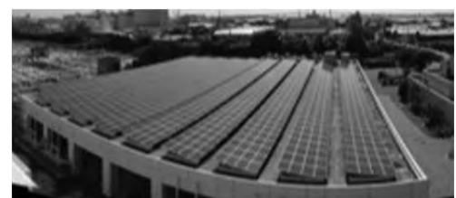
神奈川水再生センター 太陽光発電設備
