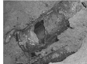
破損した取付管
