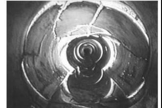
老朽化した下水道管
