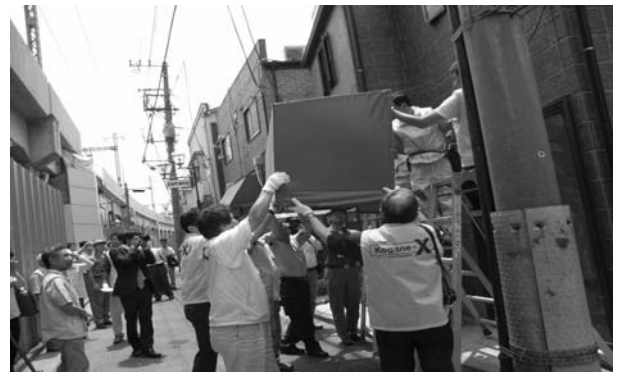
地域にとって違法営業を連想させる「日除け型テント看板」の撤去
