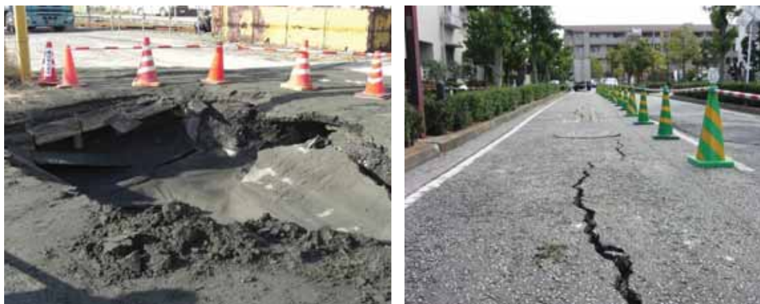
図 2-28 東日本大震災後の市内の被害状況
