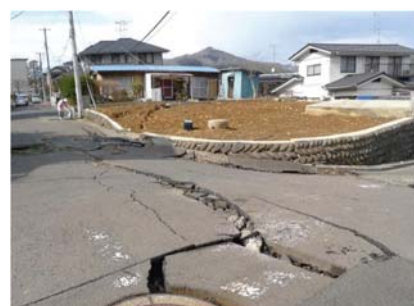
図2 東日本大震災時の滑動崩落被害（仙台市）
