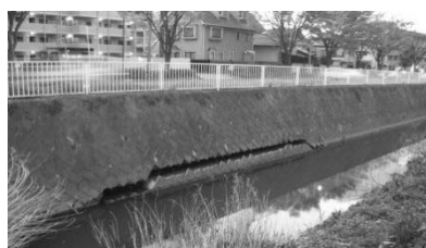
河川護岸の崩壊
