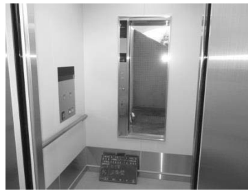
更新後(かご内部)
