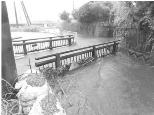
学校橋の浸水状況 (帷子川：旭区上川井町)
