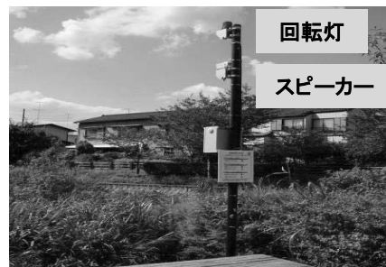
親水拠点警報装置(栄区:いたち川扇橋の水辺)
