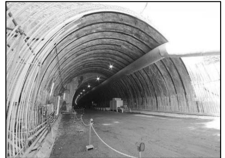
③釜谷JCT Cランプトンネル工事 （金沢区釜谷町） 平成29年11月
