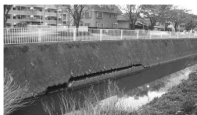
河川護岸の崩壊
