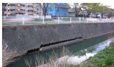
河川護岸の崩壊
