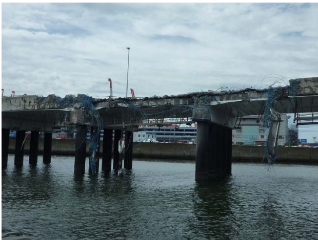
【損傷した橋梁】
