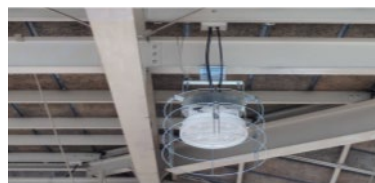
体育館照明 整備例
