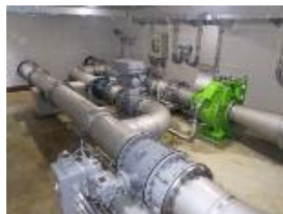
恩田配水池 小水力発電設備
