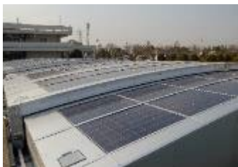
小雀浄水場ろ過池 太陽光発電設備
