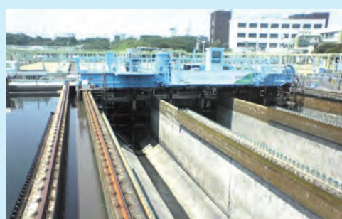
最終沈殿池の採泥機
