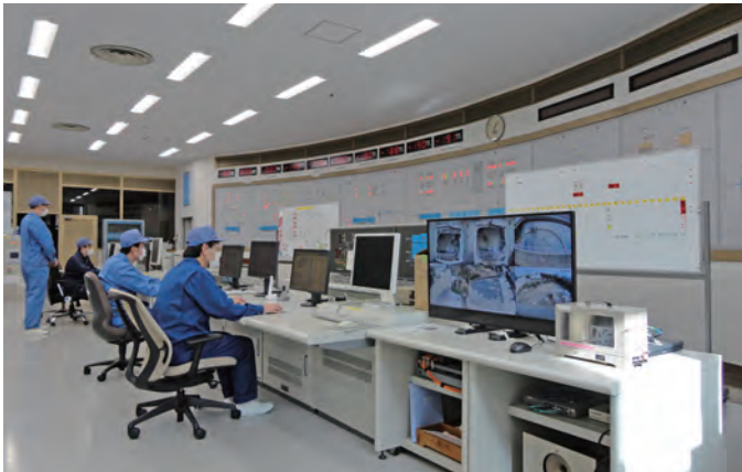
中央操作室での運転管理
