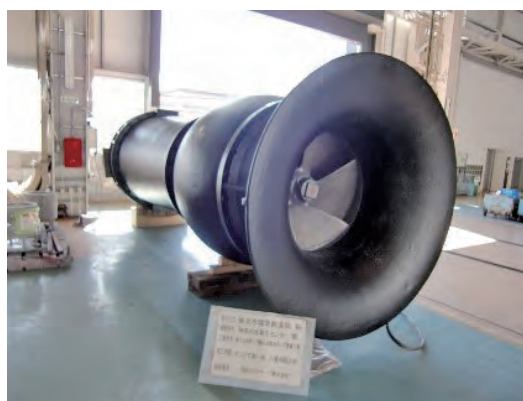
再整備後のポンプ設備
