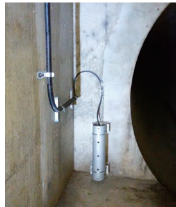
水位計設置状況
