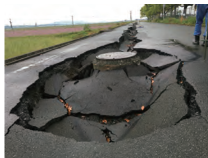
2016（平成28）年 熊本地震被害状況（下水道管）
