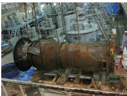
再整備前のポンプ設備
