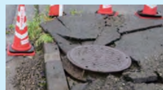
マンホール浮上被害状況
