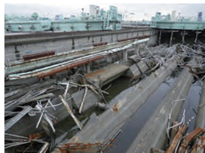
2011（平成23）年 東日本大震災被害状況（施設）
