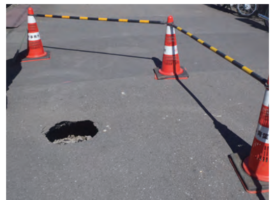
取付管破損による道路陥没
