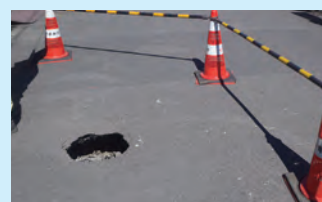
取付管破損による道路陥没
