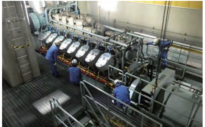
自家発電機設備の点検
