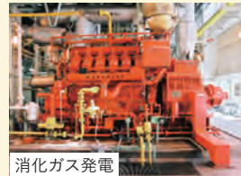
消化ガス発電
