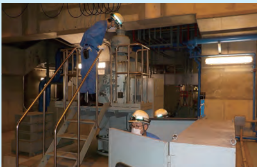
主要設備の点検 ポンプ設備
