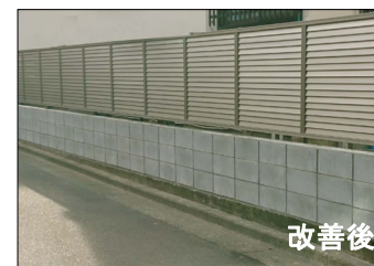
ブロック塀等の改善
