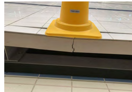
メインプール床のひび割れの状況
