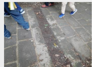
側溝に堆積した土砂
