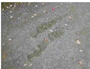
土舗装の洗堀により露出したガラ
