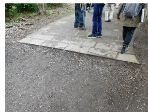
石張舗装とのつなぎ目に生じた段差
