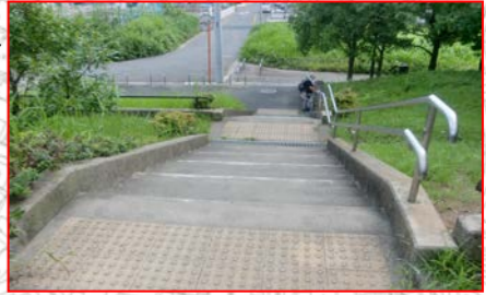
手すり 階段の手すりが基準に適合していない。(片側しかない)
