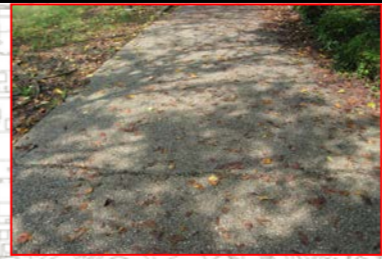
アスファルト舗装 表面にひび割れが生じている。
