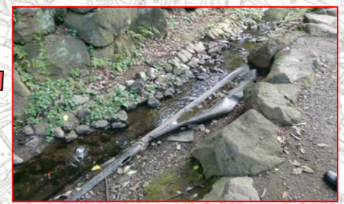
防水シート 護岸の石積みはずれて、防水シートが露出している。
