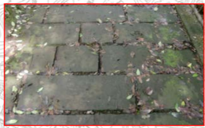
白河石舗装 (目地埋めなし) 目地が段差になっている。
