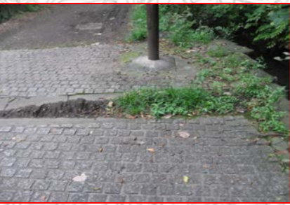
土の堆積 V型横断溝に土が堆積し、草が生えている
