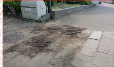
土の堆積、水たまり 石張り舗装がくぼんで、水たまりができ土が堆積している
