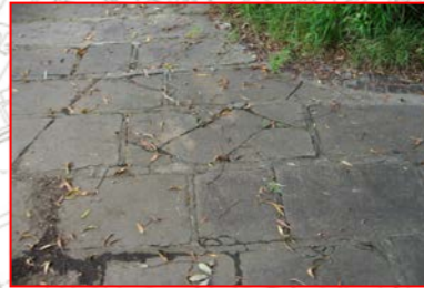
白河石舗装 根上りで石が割れている。
