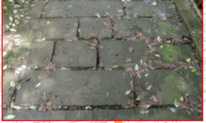
白河石舗装(目地埋めなし) 目地が段差になっている。
