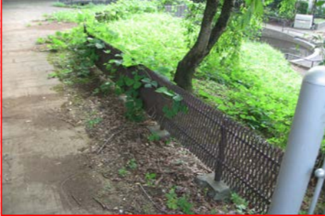
転落防止柵 高さが低く、突起がある
