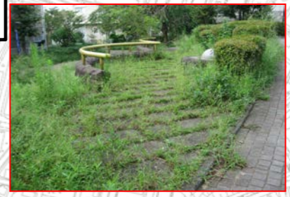
白河石舗装 (目地埋めなし) 目地が段差になっている。
