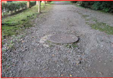
土舗装 マンホールが出っ張っている。
