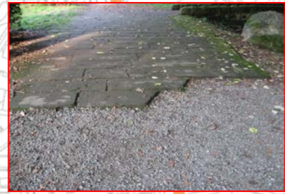
土舗装+白河石 境目に段差ができています。
